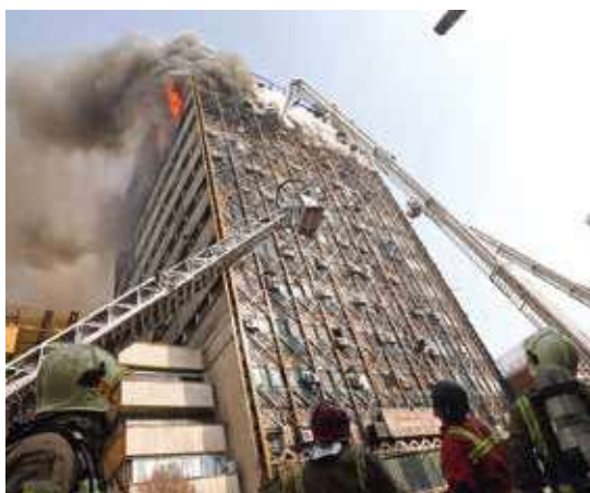
▲ Обрушение 17-этажного ТЦ при тушении через три часа после начала пожара (г. Тегеран, 19 января 2017 года). Погибли около 30 пожарных
