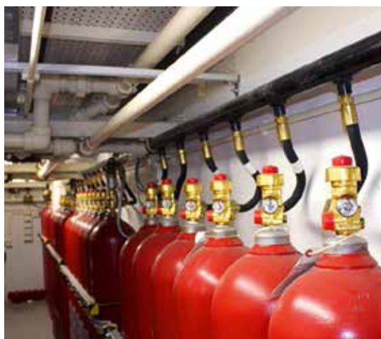
Система пожарной безопасности дата-центра в Гонконге
